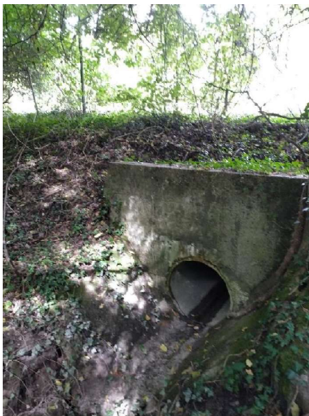
Qui reçoit par une buse les eaux du fossé bordier de l'A11
