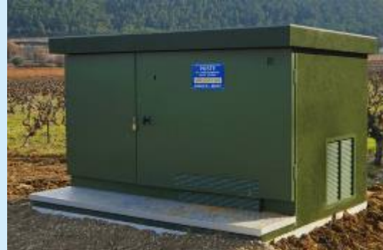
3 Le poste de livraison
